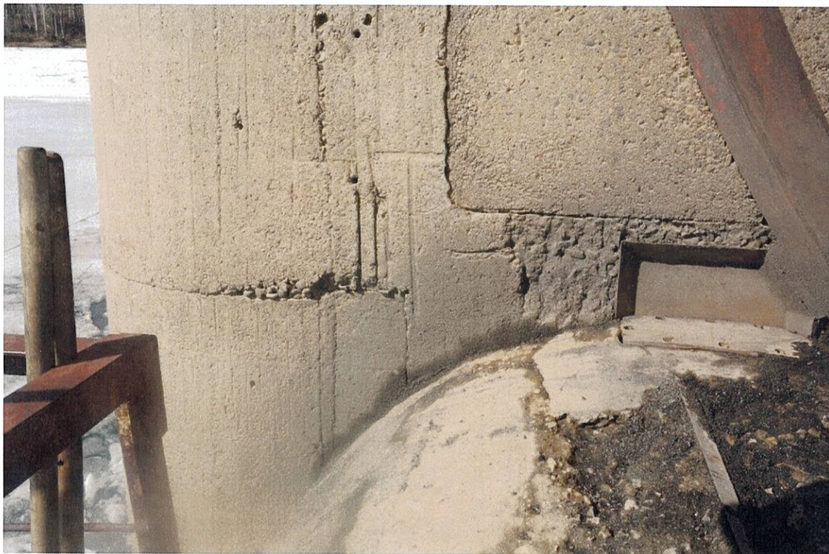
Фото.1 1 Пролет №4 Разрушение на оголовке водослива
