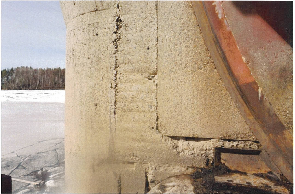
Фото 5. Пролет №3 Разрушение на быке и оголовке водослива
