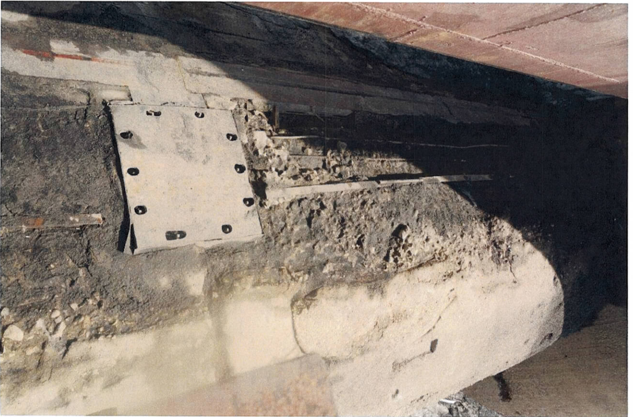
Фото 6. Пролет №4 Разрушение на оголовке водослива
