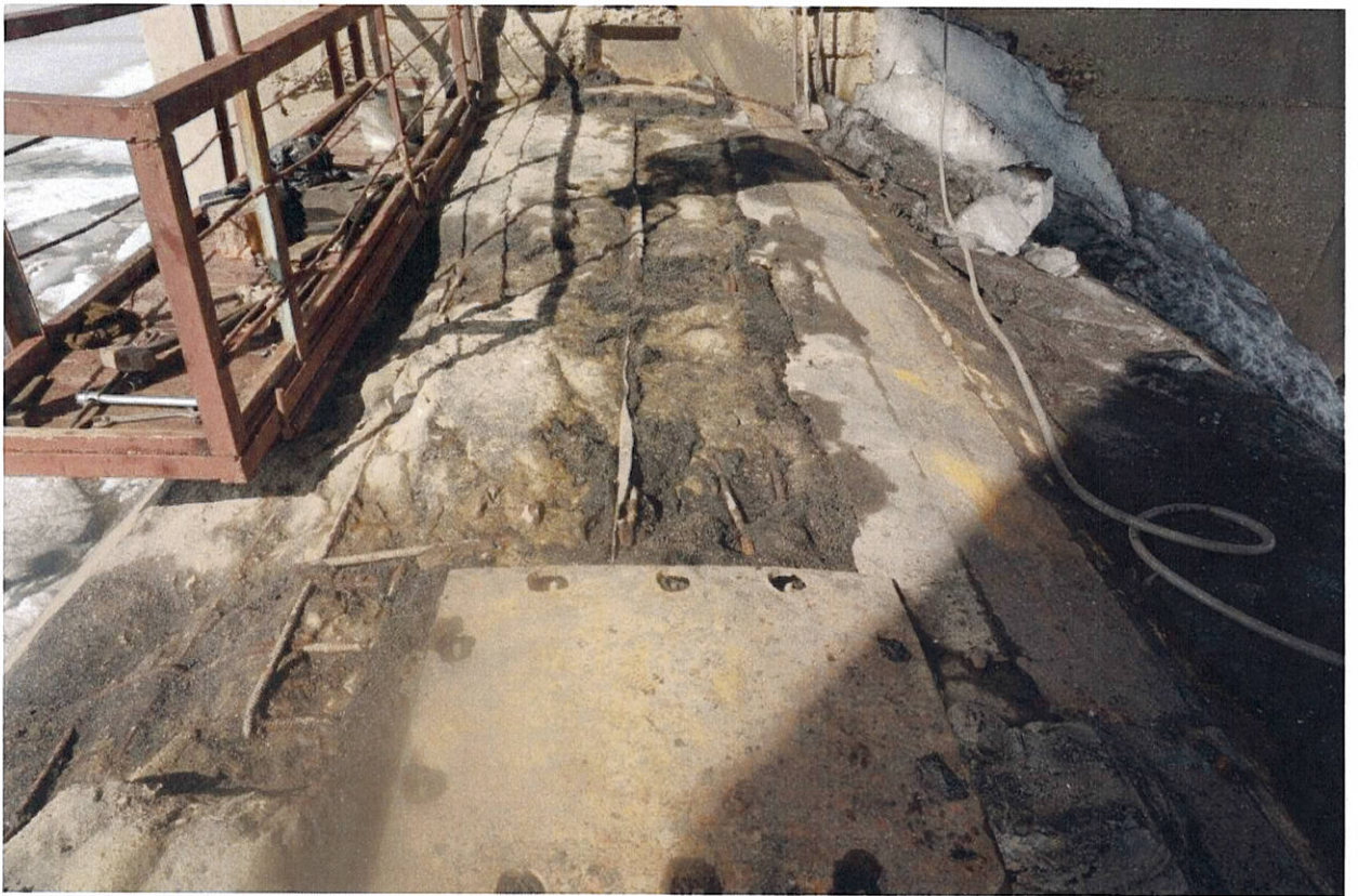
Фото 7. Пролет №3 Разрушение на оголовке водослива
