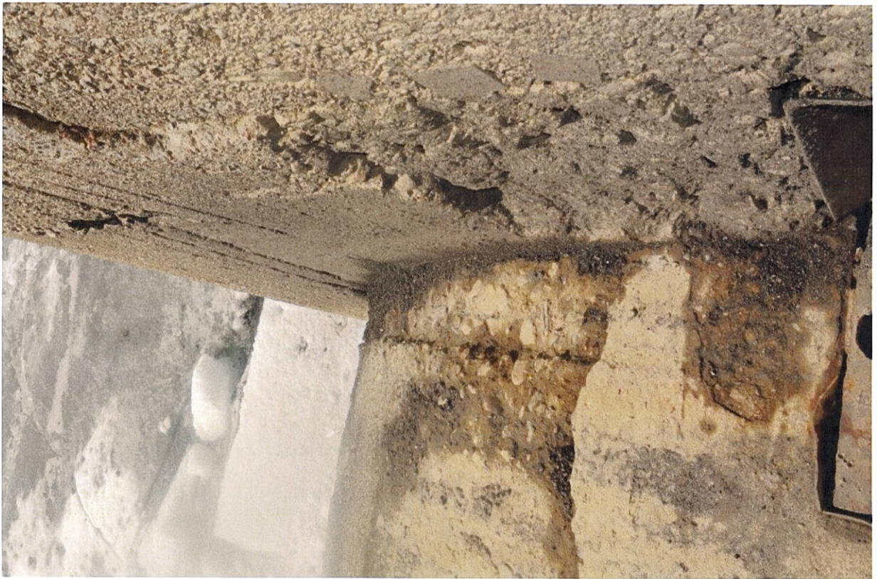
Фото 4. Пролет №4 Разрушение на оголовке водослива
