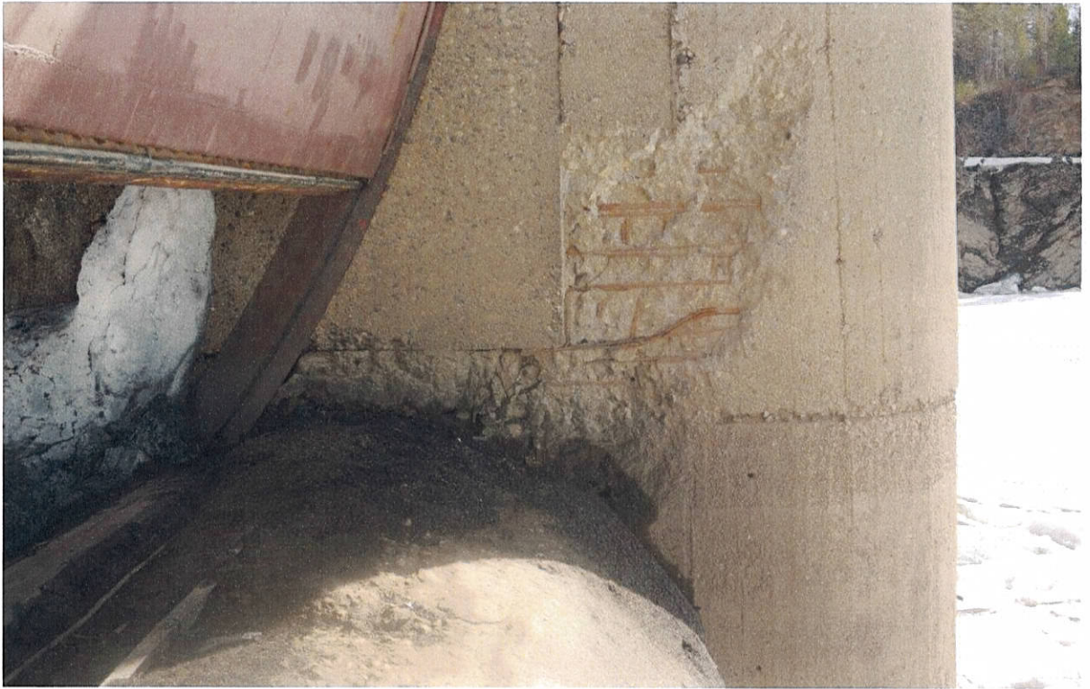
Фото 3. Пролет №4 Разрушение на быке и оголовке водослива
