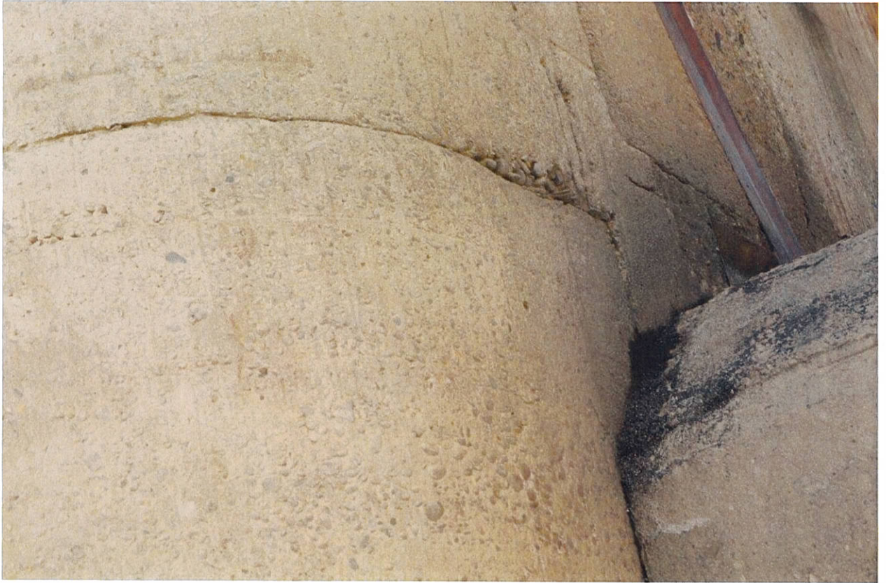
. Фото 9. Пролет №4 Разрушение угла оголовка водослива
