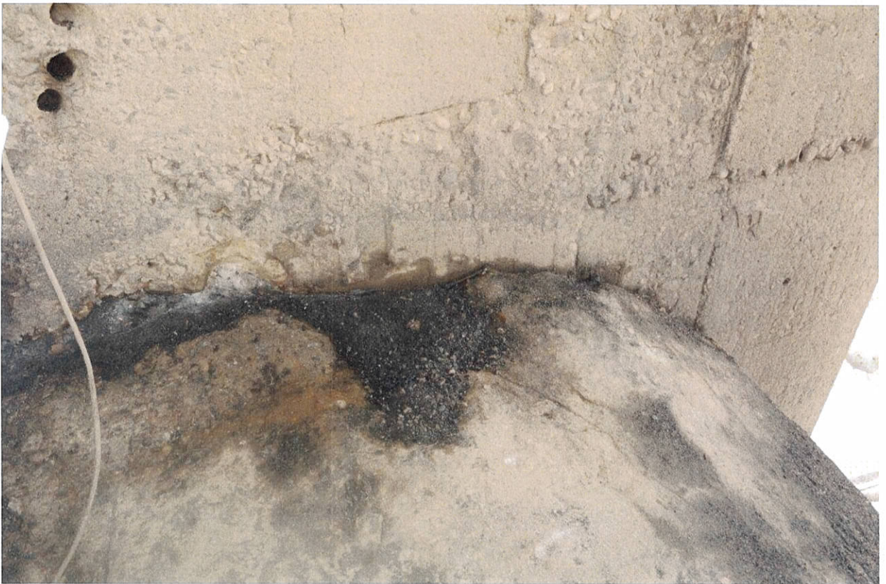
Фото 4. Пролет №3 Разрушение на оголовке водослива
