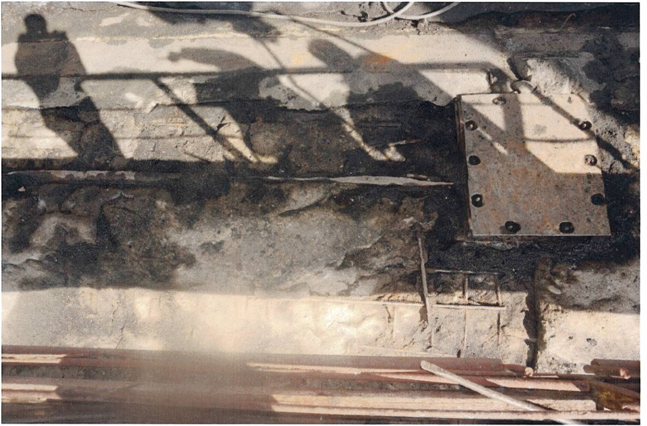
Фото. 3 Пролет №3 Разрушение на оголовке водослива
