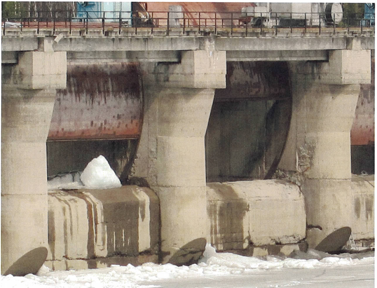
Фото 10. Пролет №3 и №4 Разрушение на межблочного шва на отм.270.00
