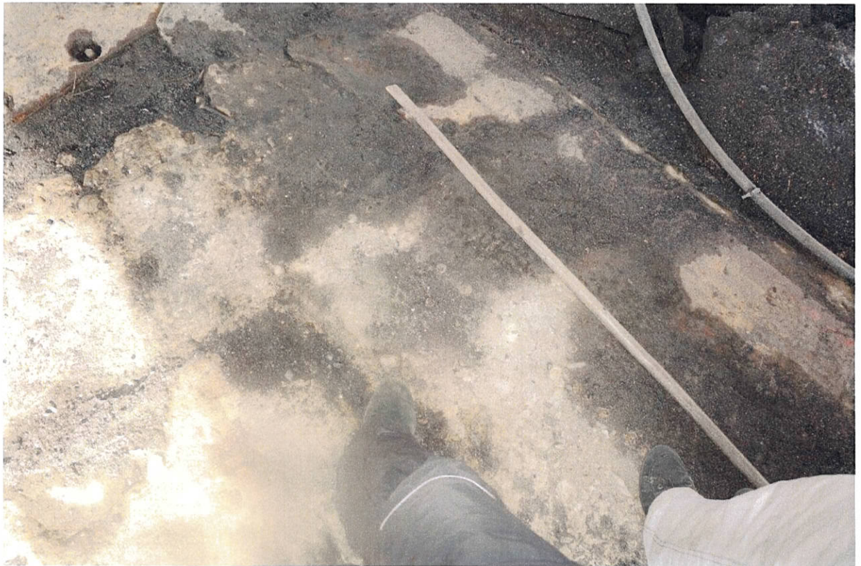
Фото 6. Пролет №3 Разрушение на оголовке водослива
