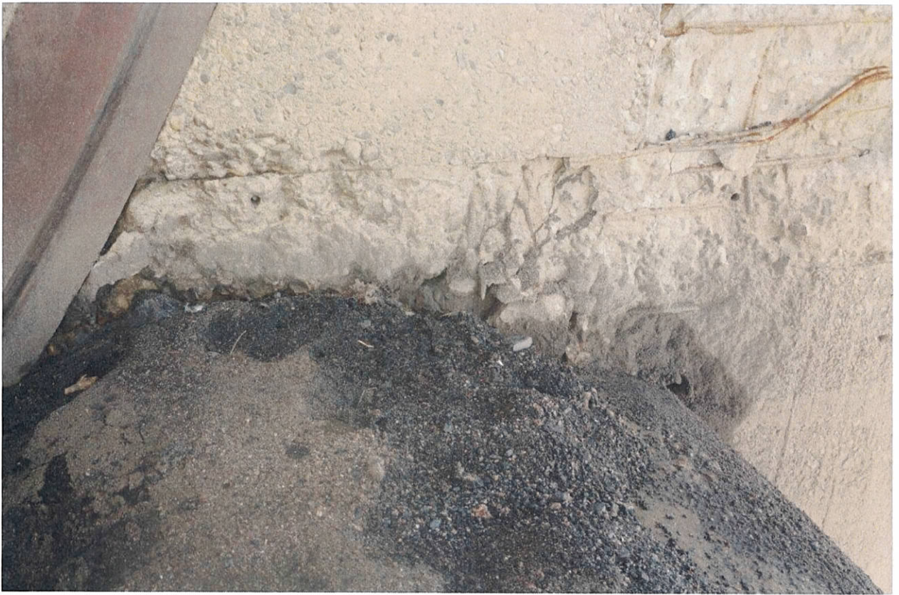
Фото 5. Пролет №4 Разрушение на быке
