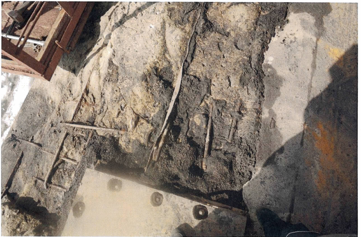
Фото 8. Пролет №3 Разрушение на оголовке водослива
