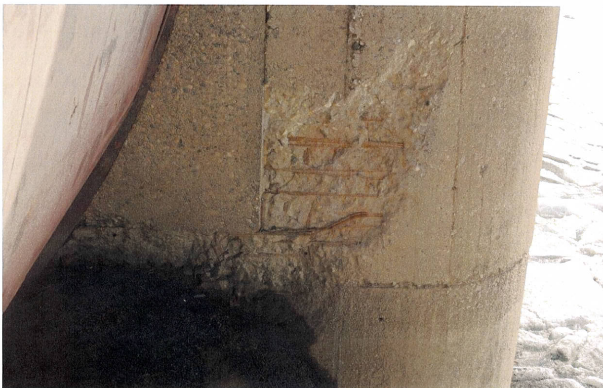
Фото 2. Пролет №4 Разрушение на быке
