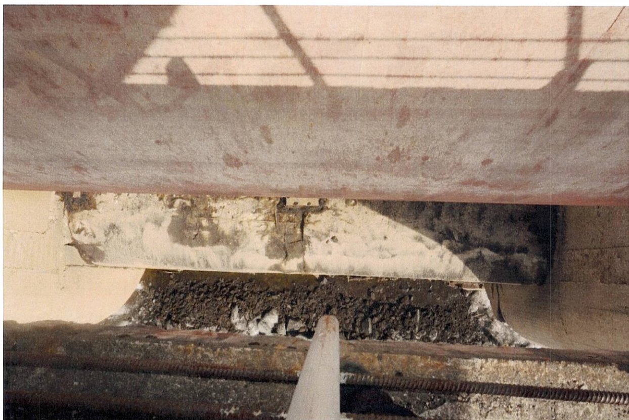
Фото 2. Пролет №3 Разрушение на оголовке водослива
