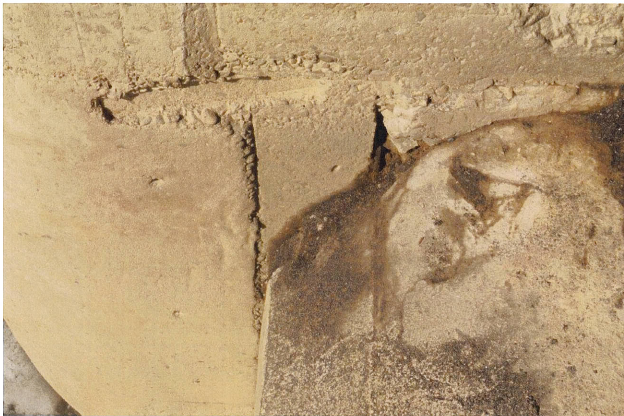
Фото 1. Фото 1. Пролет №3 Разрушение на быке и оголовке водослива
