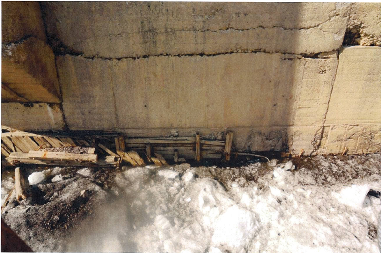
Фото 7. Пролет №4 Разрушение межблочного шва на отм.270.00
