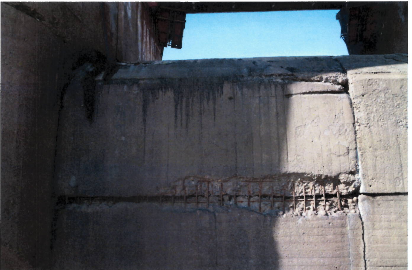
Фото 1,2. Состояние бетона оголовка водослива №2. (2015 г.)
