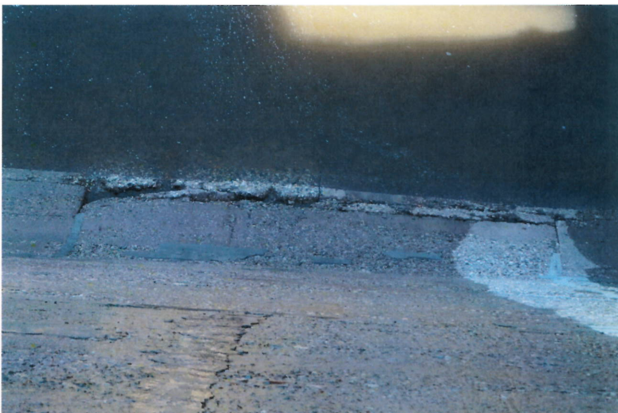
Фото 2. Разрушения в проекции 8 водосливного отверстия.
